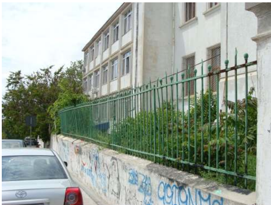
Aspecte privind degradările împrejurii existente (gard)
