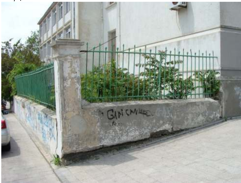
Aspecte privind degradările împrejurii existente (gard)
