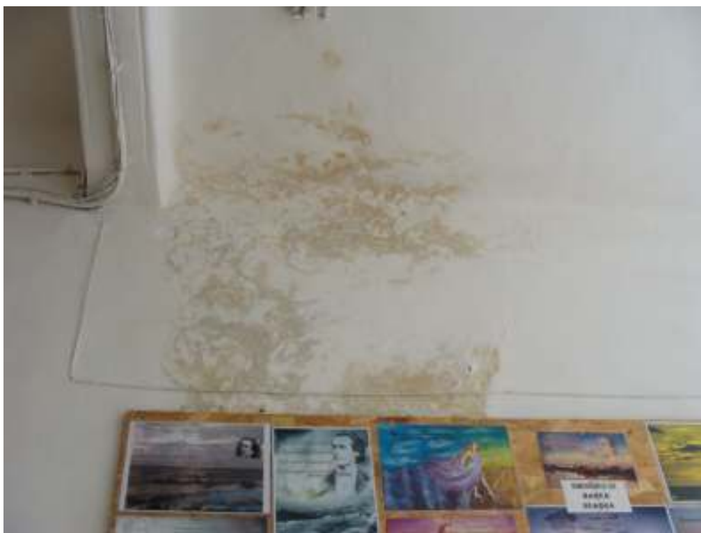
Imagini sugestive privind efectele acțiunii apelor pluviale la interior
